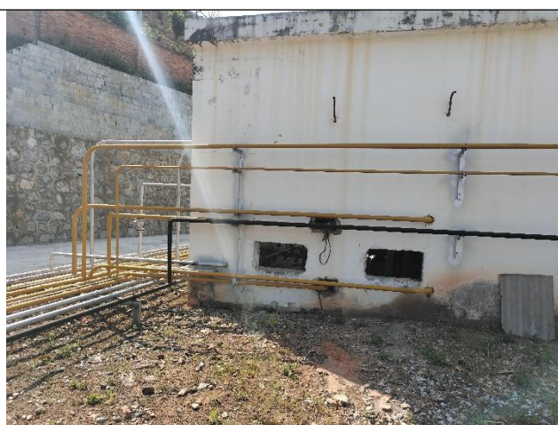
照片 16 放散管（压缩机）
