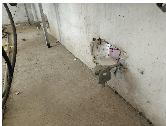
照片 22 灌瓶间可燃气体检测报警器
