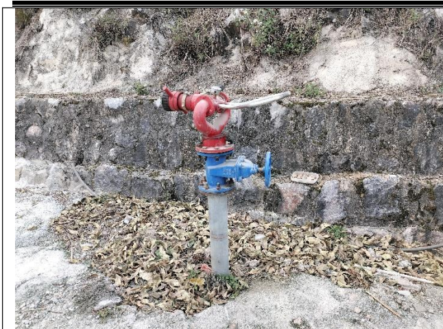
照片 29 消防水炮
