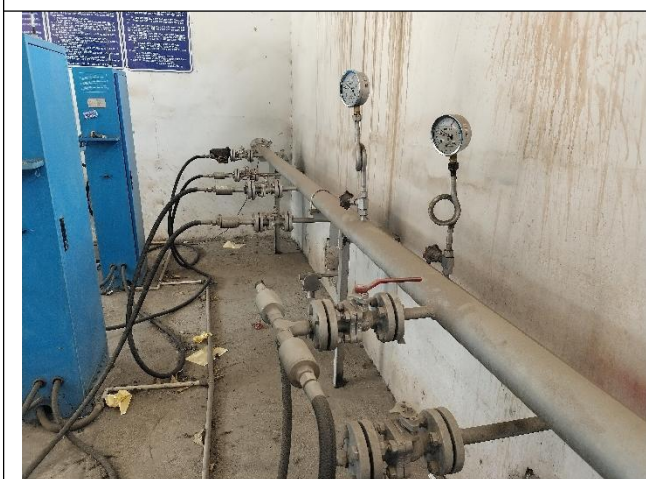
照片 21 电子自动充装秤进液管线
