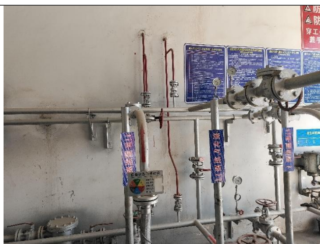
照片 14 烃泵的工艺管线
