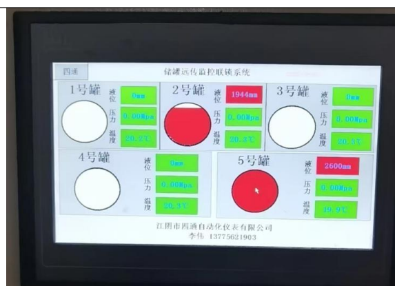
照片 39 储罐液位、温度、压力显示器
