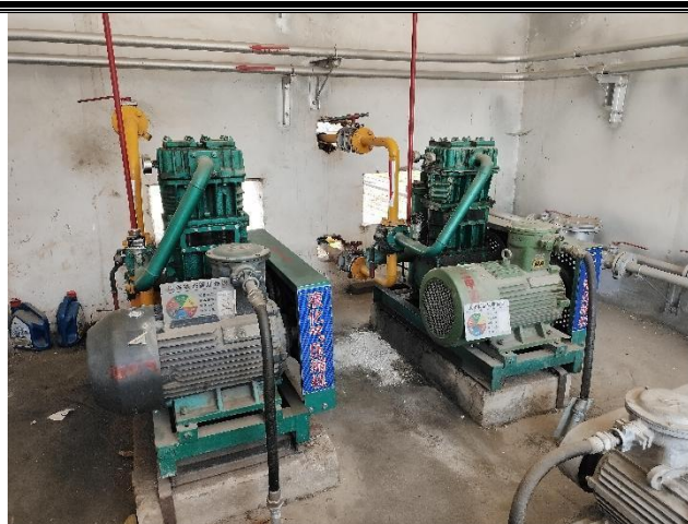
照片 18 压缩机（二甲醚和液化石油气）
