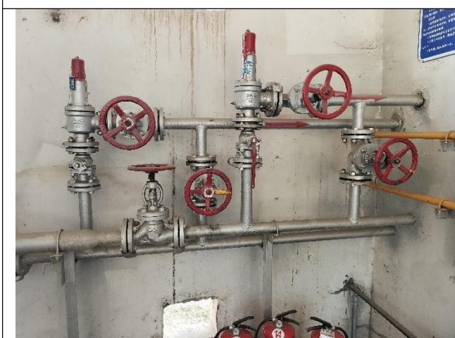
照片 19 灌瓶工艺管线和安全阀、切断阀
