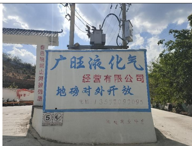
照片 32 电力变压器
