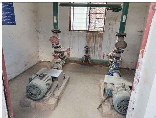
照片 27 消防水泵
