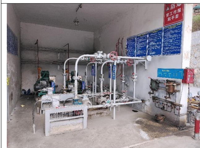
照片 15 压缩机和烃泵
