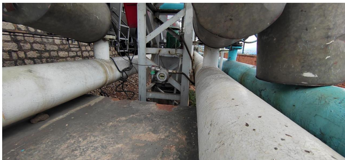
图 2-4 栈桥下方气体检测报警
