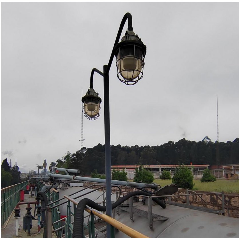
图 2-13 铁路栈桥上防爆照明装置
